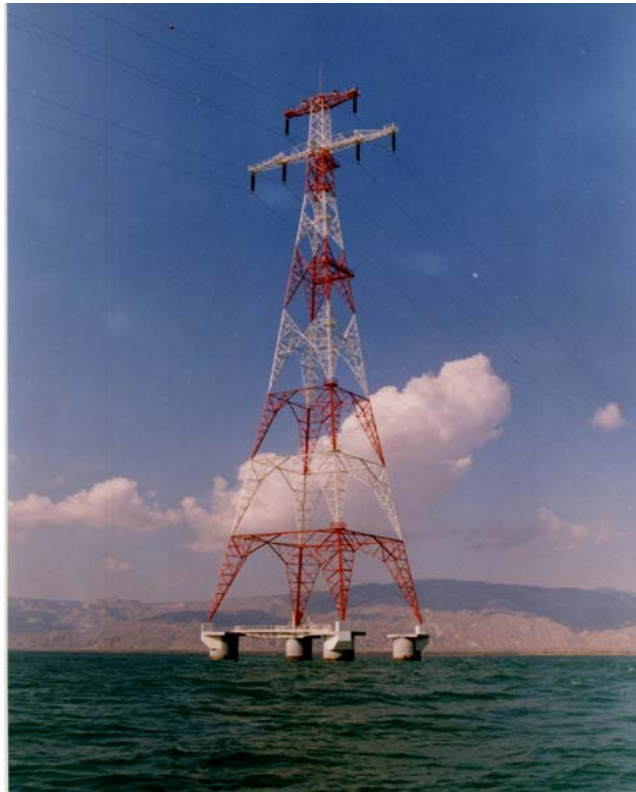
شکل ۴۳) استفاده از میله برقگیر بر روی دکل
